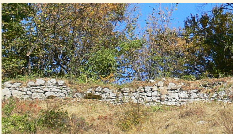
Ciot de zid de pe latura de vest a Cetății Brașovia (foto: Regia Publică Locală a Pădurilor KRONSTADT R.A.)
